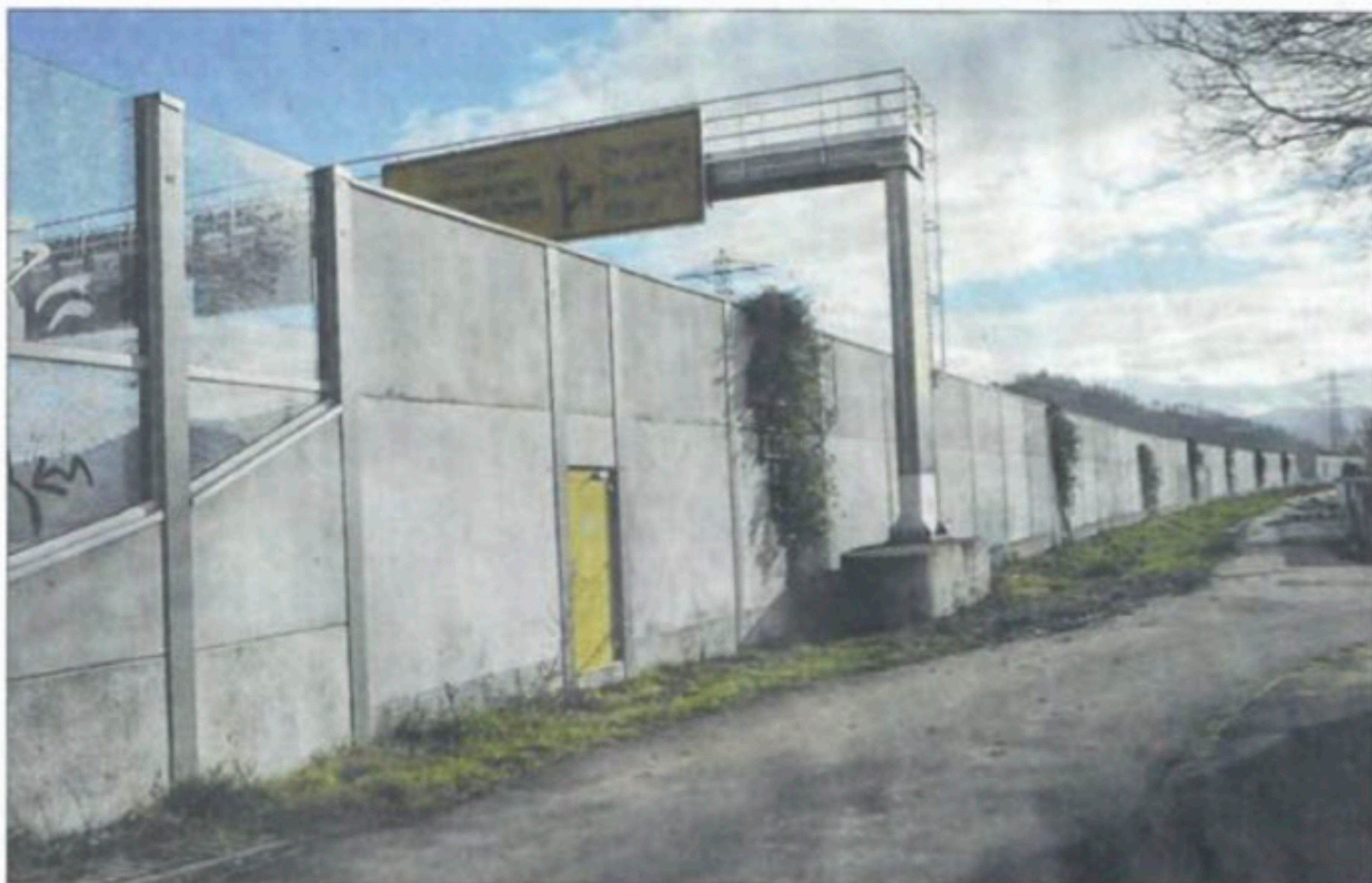
An der Lärmschutzwand an der Bundesstraße 33 bei Elgersweier soll eine Photovoltaikanlage befestigt werden.
